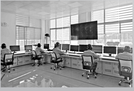
● 黄龙县圣君庙风电场中控室
