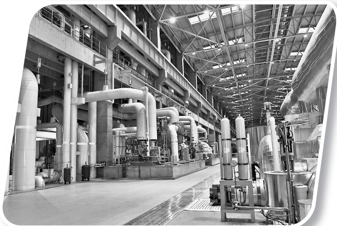
● 延长石油富县电厂项目
