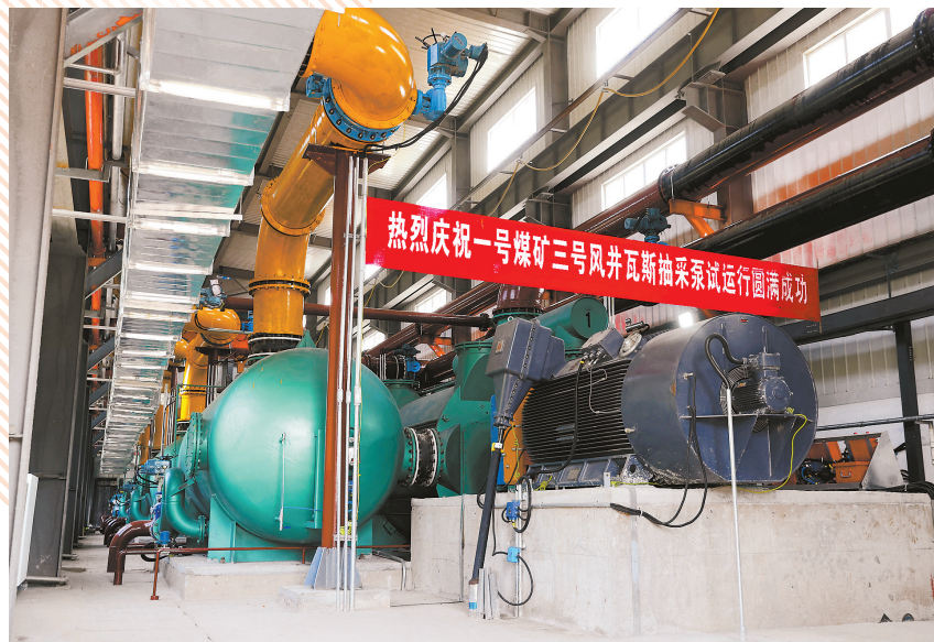
● 三号风井新增瓦斯抽采系统顺利运行
