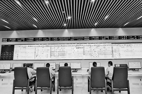
● 大唐延安富县电厂项目中控室
