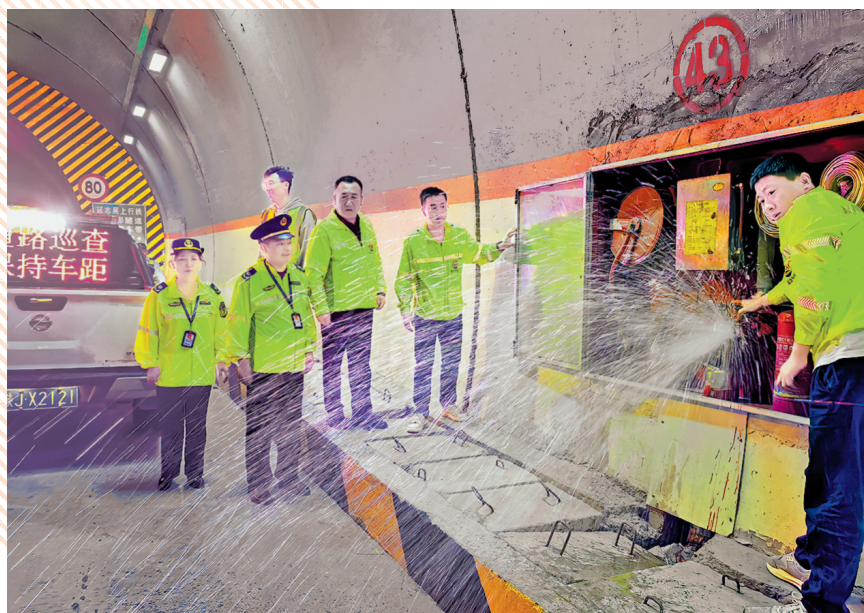
● 检查隧道消防设施
