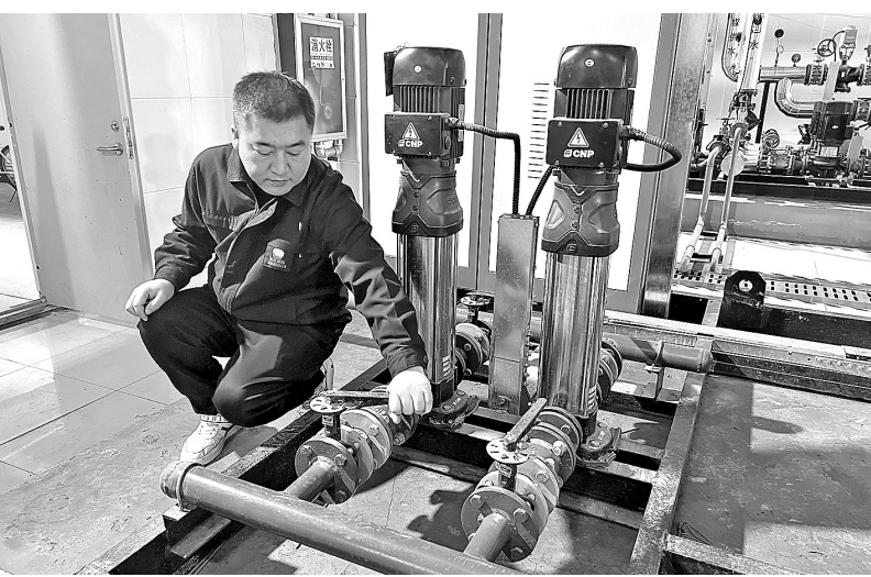
● 工作人员在检查供水管道阀门
