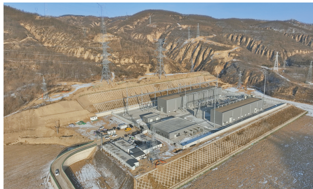
● 梁家和330千伏变电站全景
