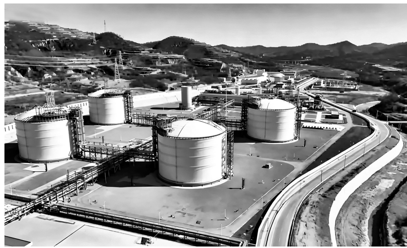
● 延长石油LNG调峰储气站
