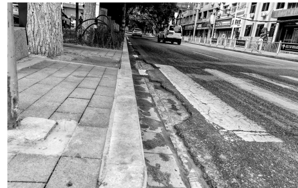
6月22日，市民张女士反映，南大街大礼堂处马路边缘有破损情况，影响城市道路美观。
