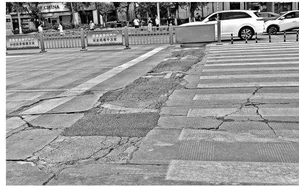
6月17日，市民李女士反映，双拥大道与永兴路交叉路口人行斑马线旁马路破损，影响市民出行安全。
