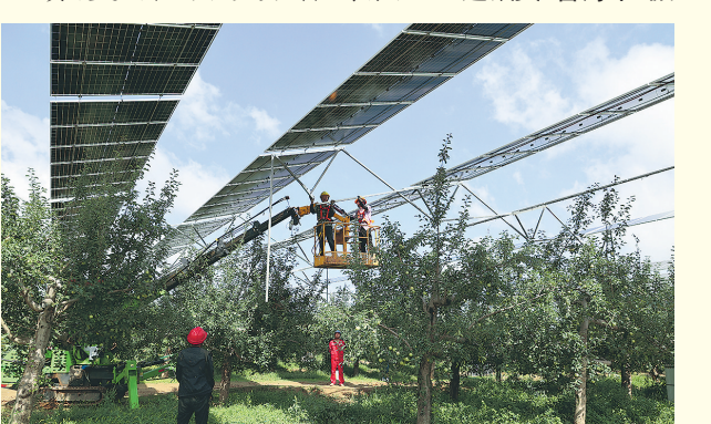
● 陕西华电宜川25万千瓦光伏发电项目安装现场(资料图片) 通讯员 李文振 摄
